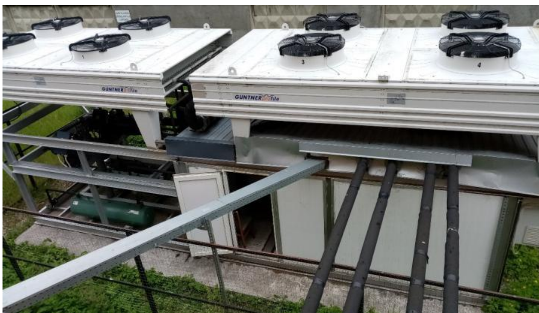
Градирни оборотного водоснабжения системы охлаждения печей выращивания слитков кремния
