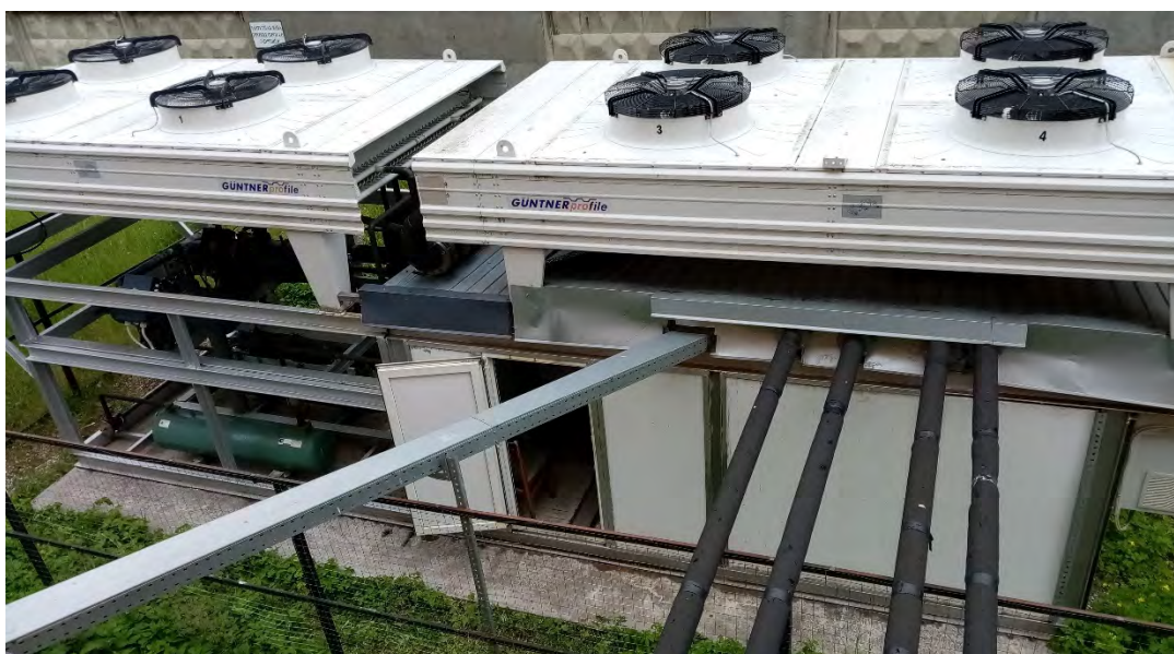
Градирни оборотного водоснабжения системы охлаждения печей выращивания слитков кремния
