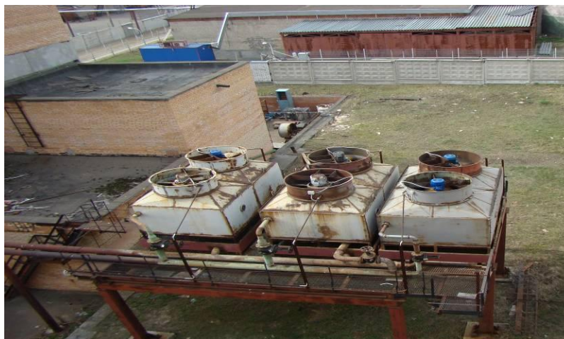
Градирни оборотного водоснабжения системы охлаждения печей выращивания слитков кремния
