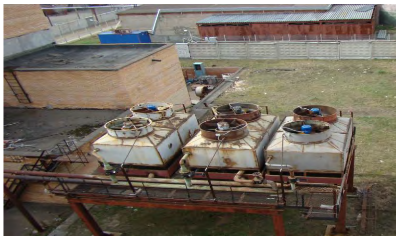
Градири оборотного водоснабжения системы охлаждения печей выращивания слитков кремния
