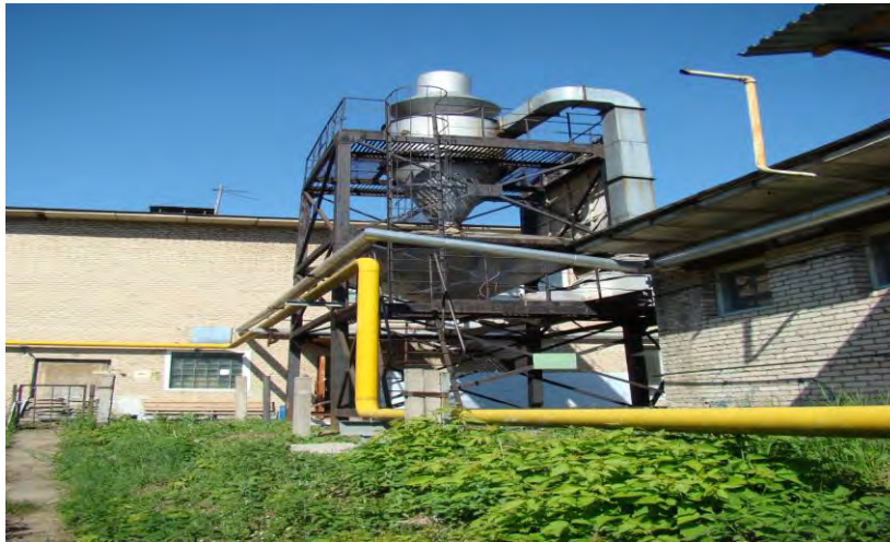
Пылеулавливающая установка от деревообрабатывающих станков
